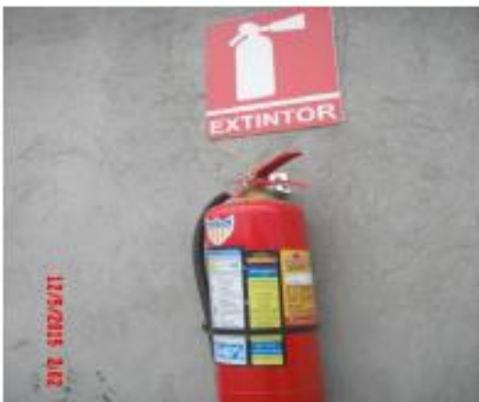
Extintor colocado en el exterior de la Planta.
