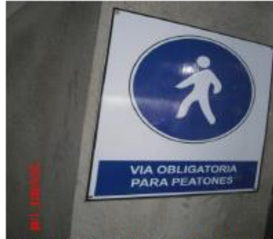
Señales de obligación instaladas en la Planta.
